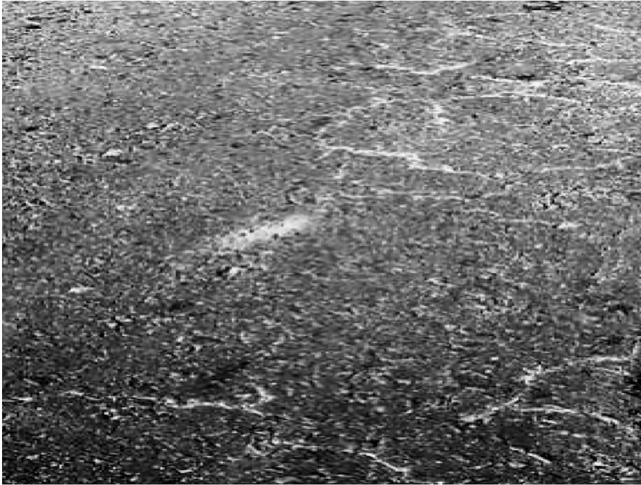
Figura 11. Fisuras entrelazadas en pavimento asfáltico, con afloramiento de material pulverulento (Fotografía de los autores)
